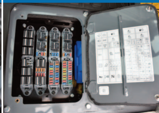
Quadro fusibili sotto al piano cabina
