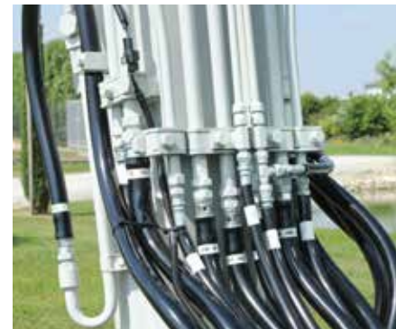
Linee idrauliche in acciaio e morsetti di sostegno in gomma e metallo ben distribuite.
